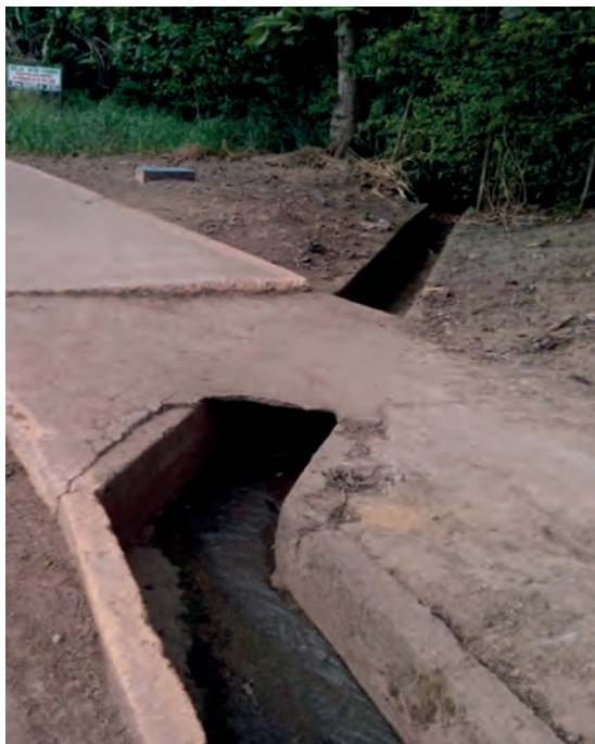
Figura 7: Escoamento de água das chuvas e esgoto
