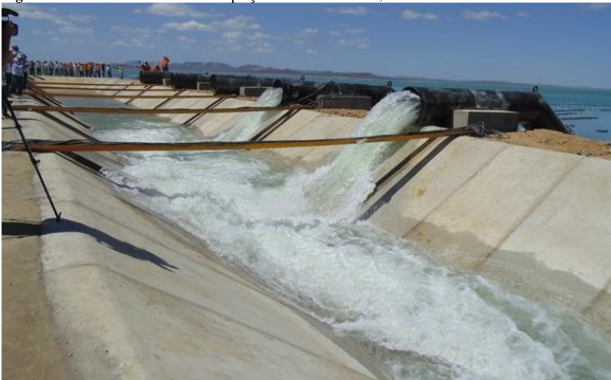
Figura 108 - Estrutura flutuante de captação Polo Nilo Coelho, Petrolina - PE. Casa Nova - BA.
