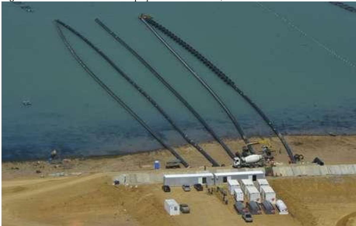
Figura 106 - Estrutura flutuante de captação Polo Nilo Coelho, Petrolina - PE. Casa Nova - BA.
