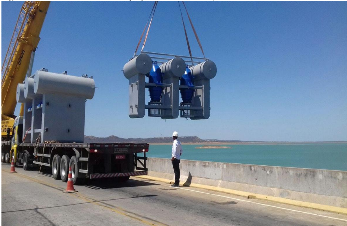
Figura 103 - Estrutura flutuante de captação Polo Nilo Coelho, Petrolina - PE. Casa Nova - BA.
