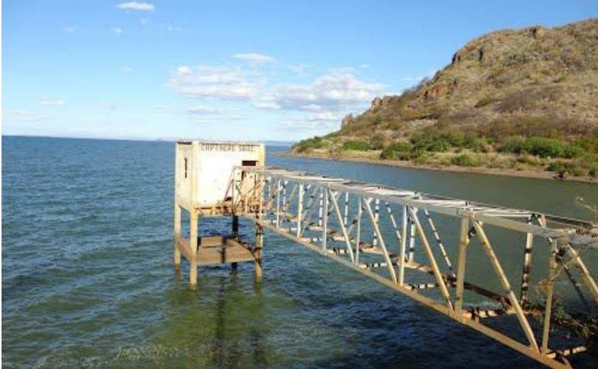
Figura 98 - Estrutura Hidráulica de Captação de água período úmido. - CODEVASF. Sento Sé - BA.
