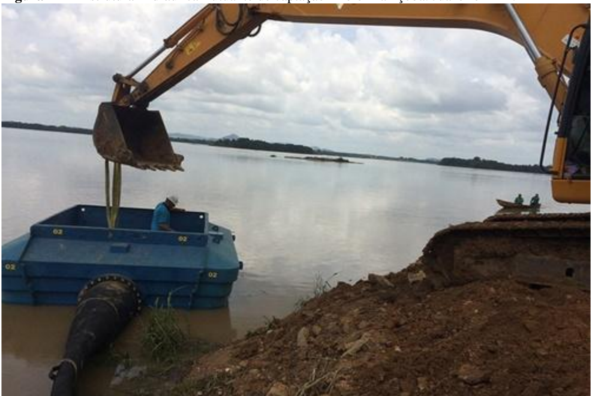
Figura 111 - Estrutura Hidráulica flutuante de captação - Polo Maniçoba. Juazeiro - BA.
