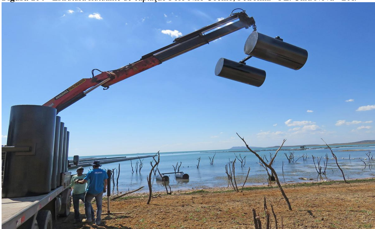
Figura 104 - Estrutura flutuante de captação Polo Nilo Coelho, Petrolina - PE. Casa Nova - BA.
