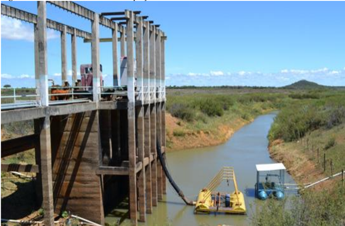
Figura 99 - Estrutura Hidráulica de Captação com bomba flutuante. - CODEVASF Sento Sé - BA.
