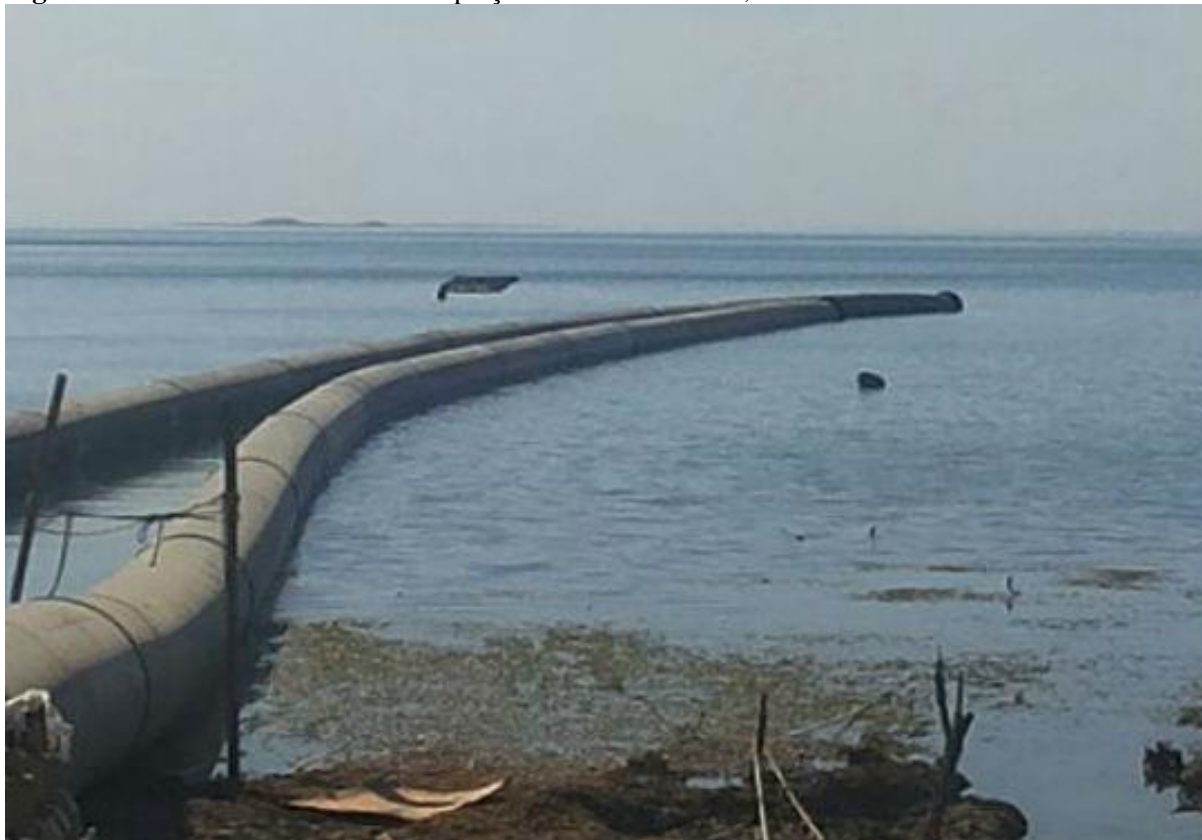
Figura 107 - Estrutura flutuante de captação Polo Nilo Coelho, Petrolina - PE. Casa Nova - BA.
