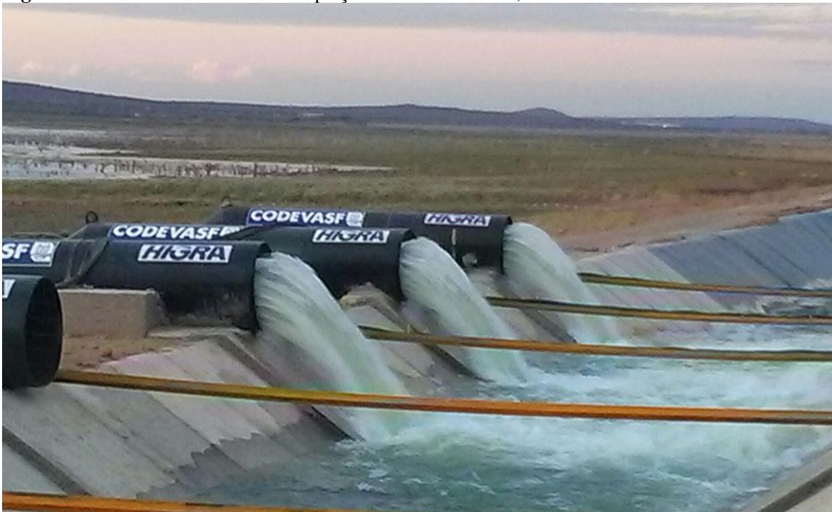
Figura 109 - Estrutura flutuante de captação Polo Nilo Coelho, Petrolina - PE. Casa Nova - BA.
